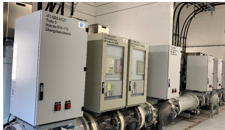
Neue GIS-Anlage gasisolierte Schaltanlage
